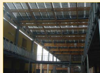
Scheuten Solar BIPV installation.
